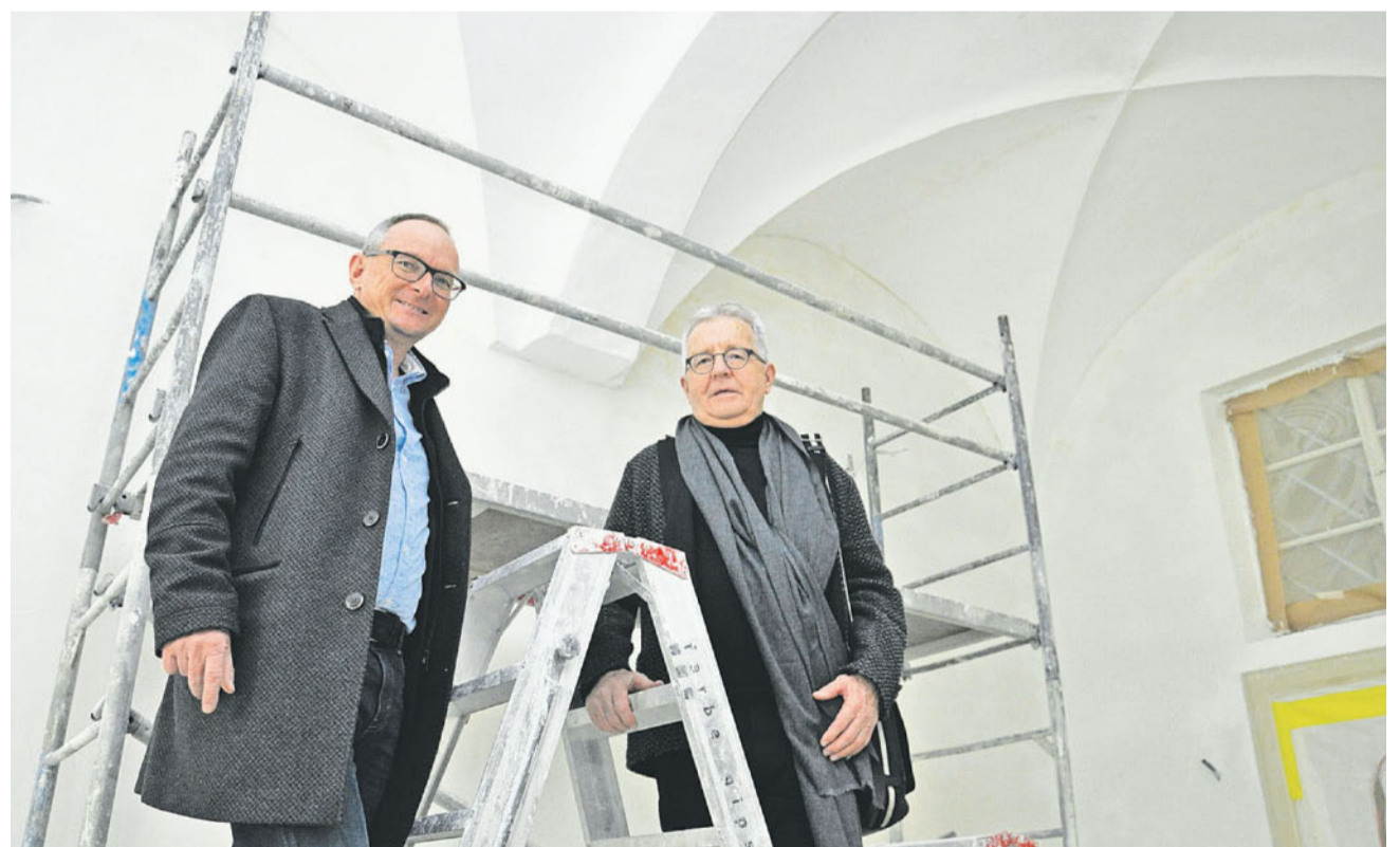
In der Sakristei. René Julen (links) und Architekt Hans Imhof begutachten aus leicht luftiger Höhe den Stand der Arbeiten: Der sakrale Raum wird umfassend restauriert und künftig zum Ausstellungsraum von wertvollen Kirchenschätzen. FOTO Wk
