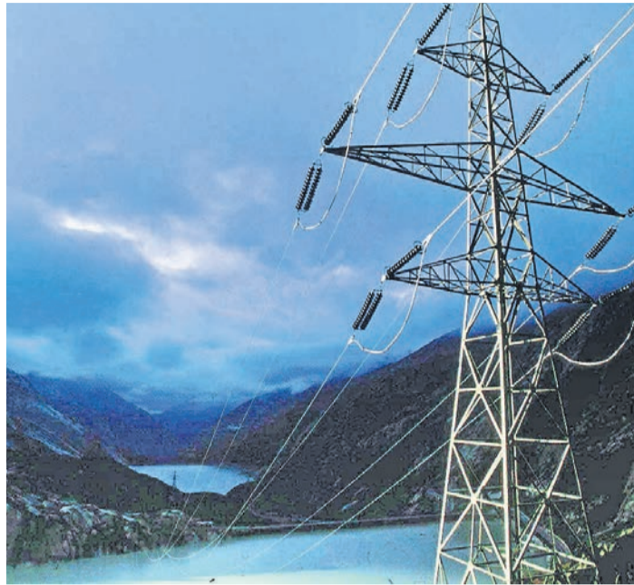
Klimaziele. Die Energieperspektiven 2050+ des Bundesamtes für Energie gehen davon aus, dass die Wasserkraft 2050 etwa 45 Terawattstunden Strom liefern soll, rund 53 Prozent des gesamten Bedarfs. Im Bild: Kraftwerk Grimsel. FOTO POMONA.MEDIA
